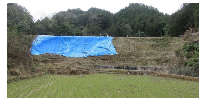
写真1 ため池堤体取付部付近の豪雨による被害例
